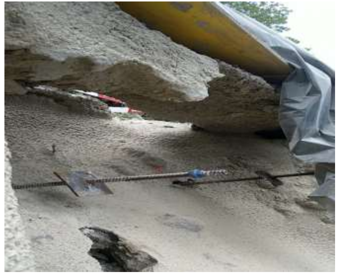
Sicherung des Einsturzgebietes Juni 2019
